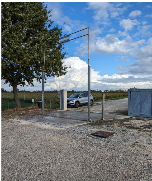
Foto 20. Arco di disinfezione in corrispondenza dell'accesso carraio
