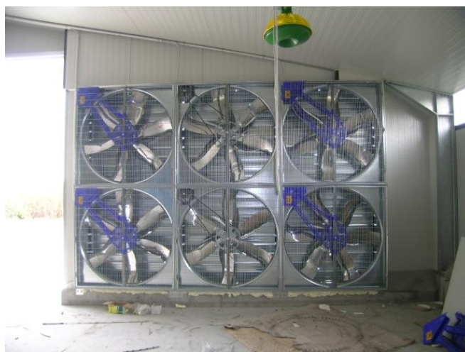
Foto 2: visione dei ventilatori
