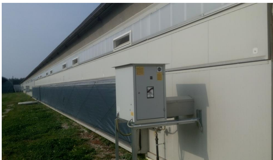
Foto 8 : Visione del generatore di calore da 80 kw esterno a GPL
