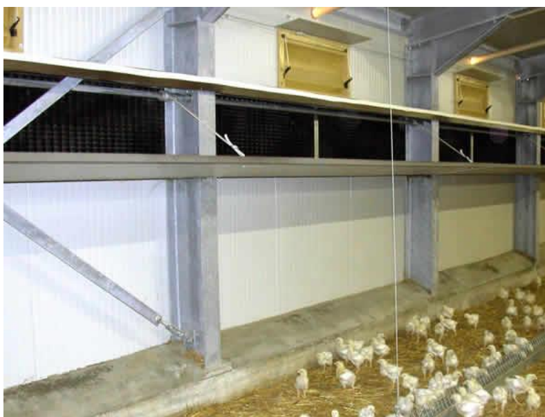
Foto 5: visione della presa d'aria estiva
