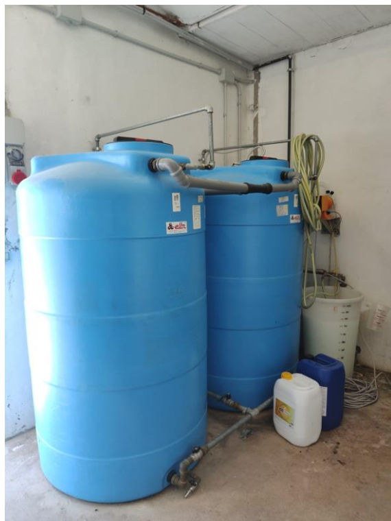
Foto 22 Serbatoi di accumulo dell'acqua di abbeverata
