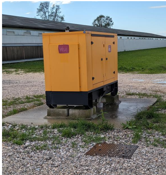
Foto 12 Visione del gruppo elettrogeno ausiliario
