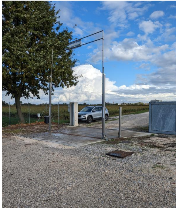
Foto 20. Arco di disinfezione in corrispondenza dell'accesso carraio
