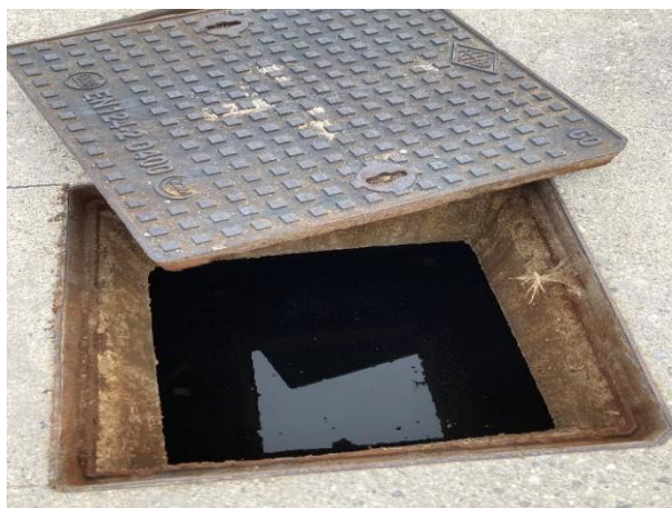
Foto 19. Pozzetto a tenuta di ricezione delle acque di lavaggio della piazzola a fine ciclo
